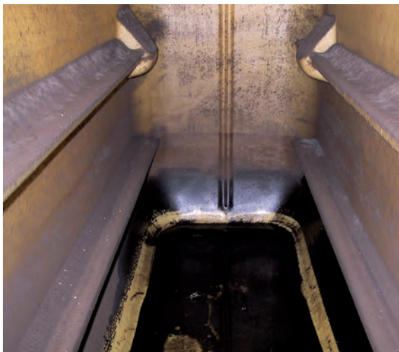
Das saubere Öl ist abgepumpt, man sieht den Schlammrückstand
